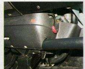
Heizung: Leckt der Hahn? Funktionieren die Schieber?
